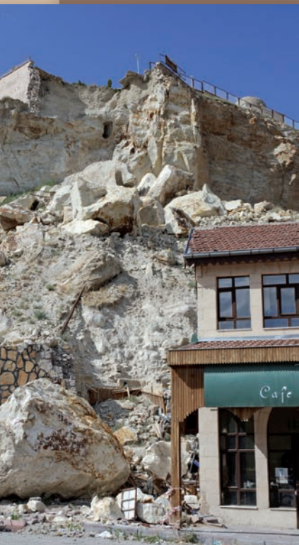
Comercio dañado por terremoto en Capadocia, Turquía.
